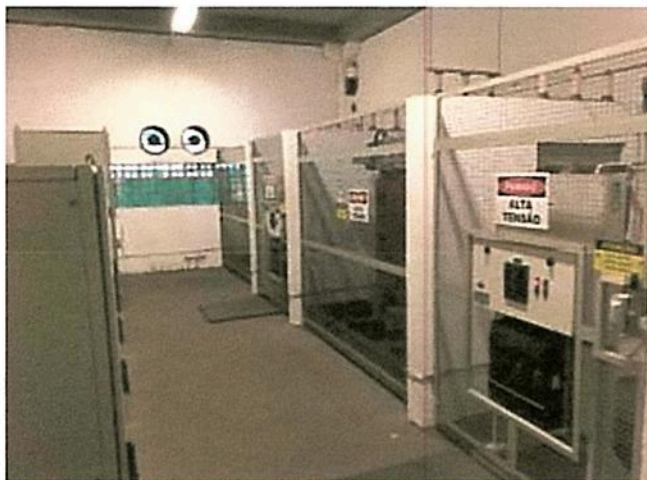
6º Andar - Subestação
