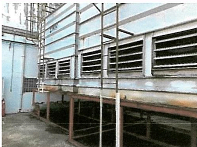
6º Andar - sistema de água gelada
