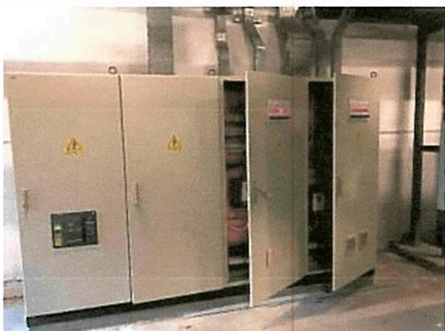
6º Andar - painéis compressores
