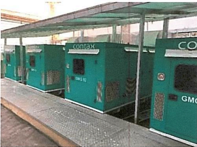
6º Andar - Grupos geradores
