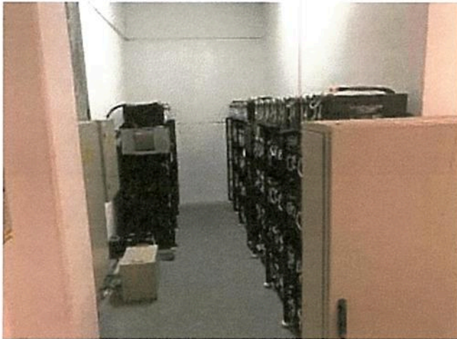
6º Andar - Baterias
