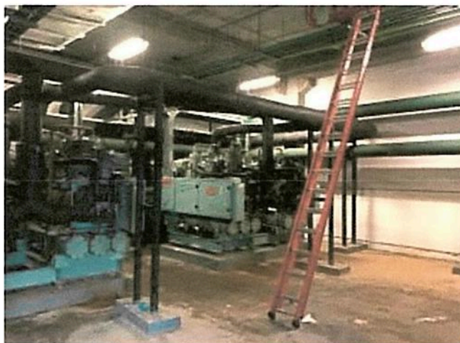
6º Andar - Compressores
