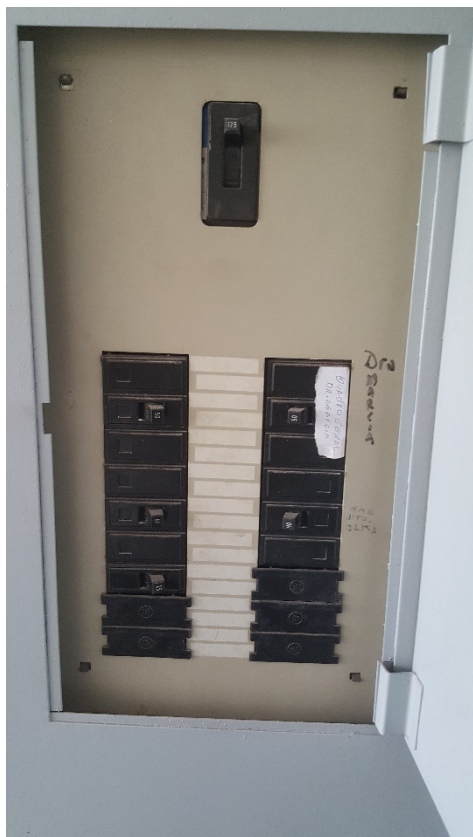
Quadro elétrico - Disjuntores tipo NEMA sem identificação dos circuitos
