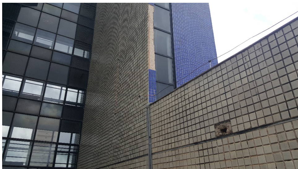
Fachada - deslocamento de revestimento cerâmico e desgaste de rejunte
