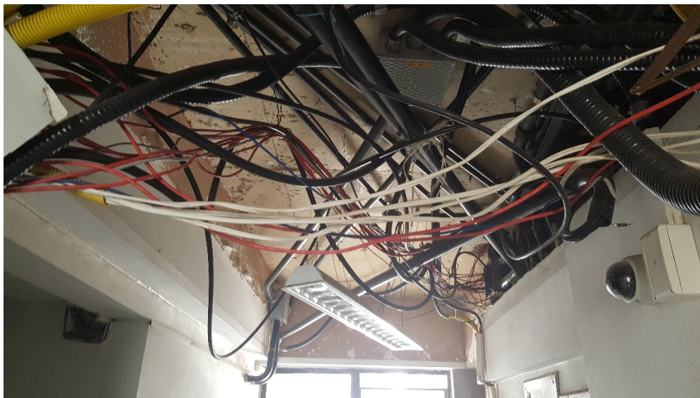
Instalações elétricas - Desorganização da infraestrutura
