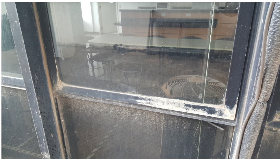
Fachada - avarias no alumínio da pele de vidro decorrente de desgastes naturais
