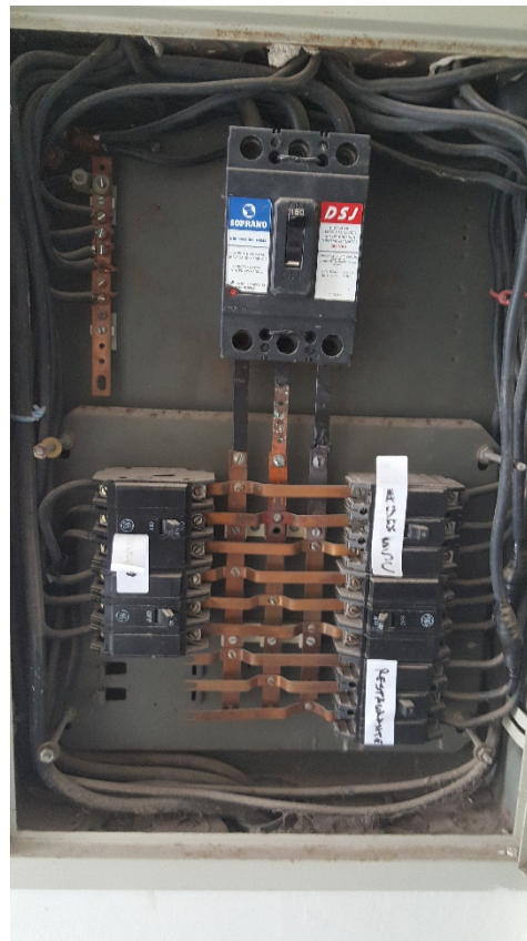
Quadro elétrico - Barramento energizado desprotegido
