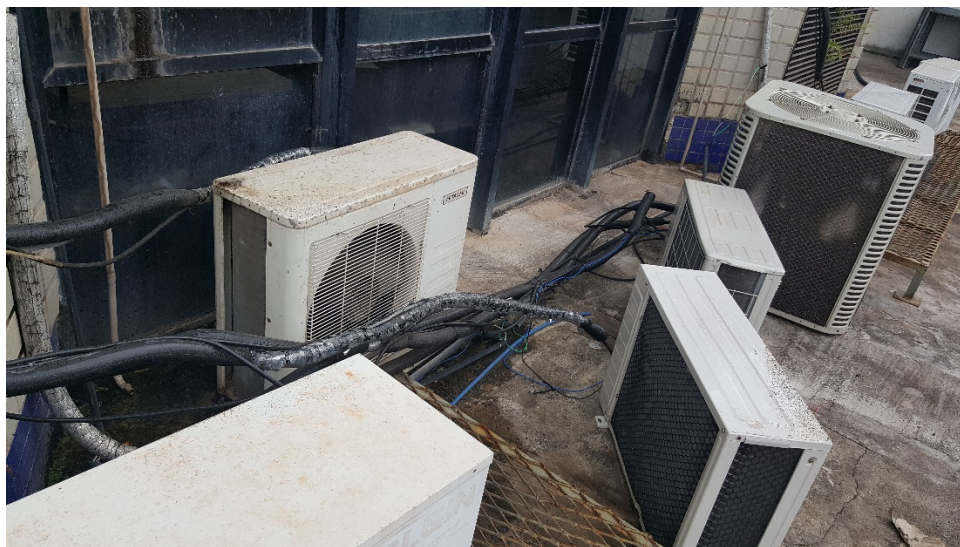
Splits - tubulação frigorígena com problemas no isolamento e fiação elétrica isolada
