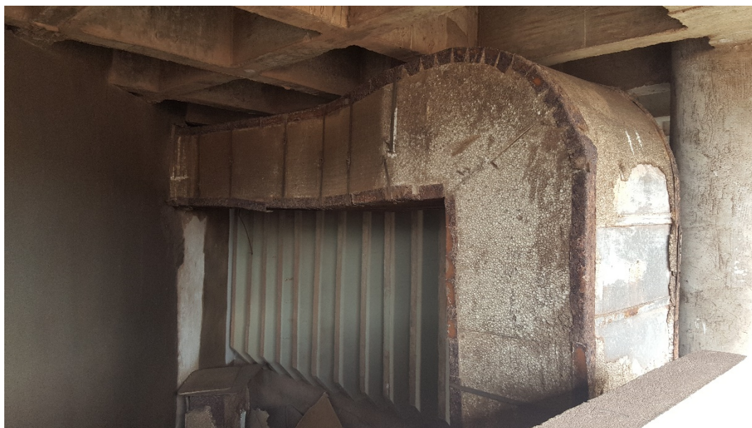
Self-contained - Duto com problemas no isolamento
