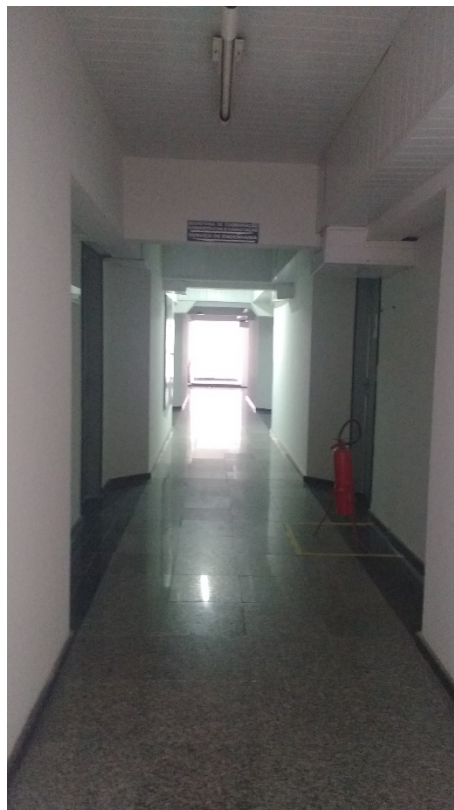
Rota de fuga sem sinalização e iluminação de emergência
