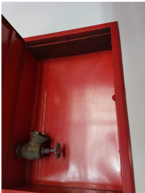
Caixa de hidrantes sem equipamentos
