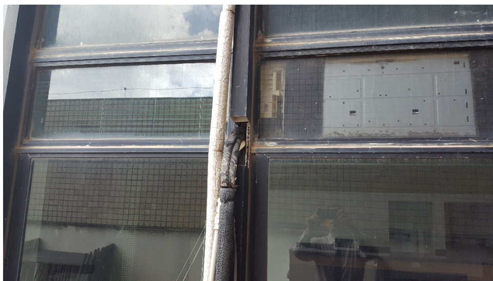
Fachada - avarias no alumínio da pele de vidro decorrentes da instalação de splits
