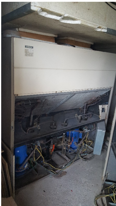
Self-contained - Equipamento com avarias em funcionamento
