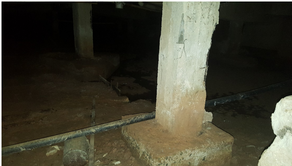
Peça estrutural com patologia - oxidação de armadura
