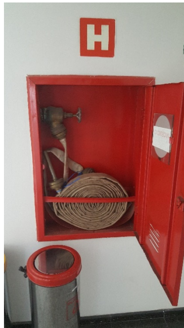
Caixa de hidrantes mangueira com desgaste na superfície externa
