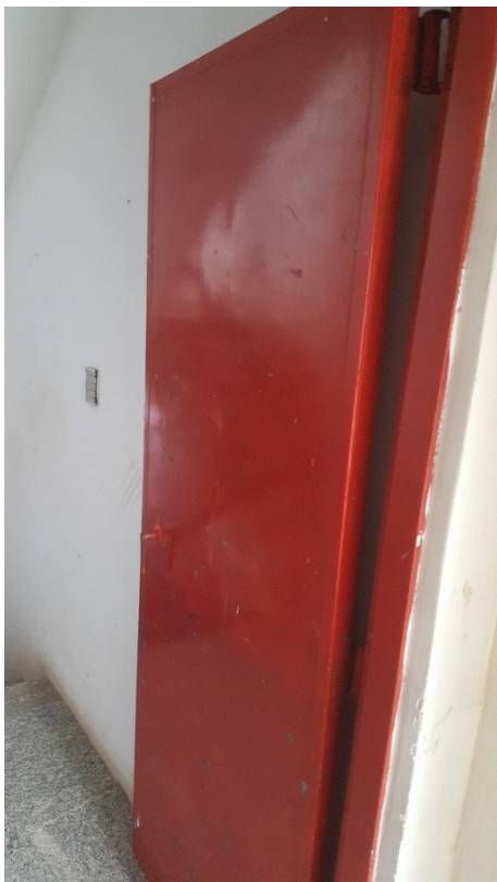
Escada de emergência existente - portas corta-fogo com problemas de abertura
