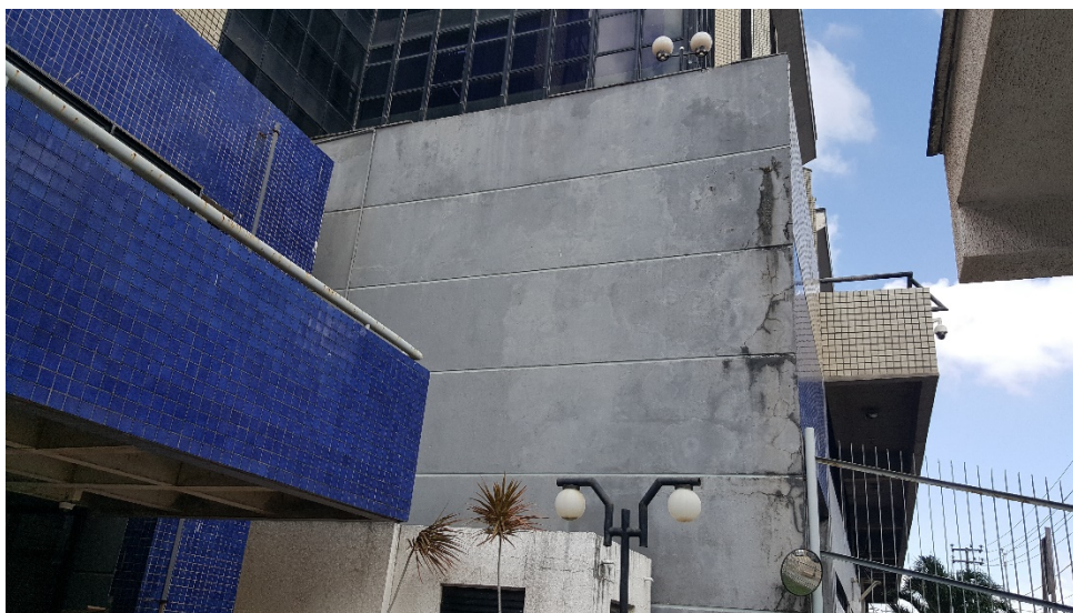
Fachada - rachaduras e infiltrações
